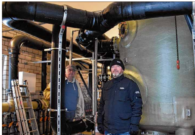
Peter Hunger (links) und Ralf Gläsing vom Waldbadverein Elend zeigen die neue Wasseraufbereitungsanlage. Foto: Katrin Schröder
