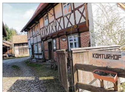
Der Komturhof Darlingerode stand bereits 2020 auf der Prioritätenliste. Er soll 2021 umfassend saniert werden. Foto: Jörg Niemann
